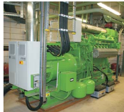
BHKW zur Stromerzeugung
