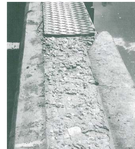
Mechanische Schäden an der Wandkrone
