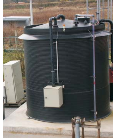
Lagertank für Eisen(II)-Chlorid-Lösung
