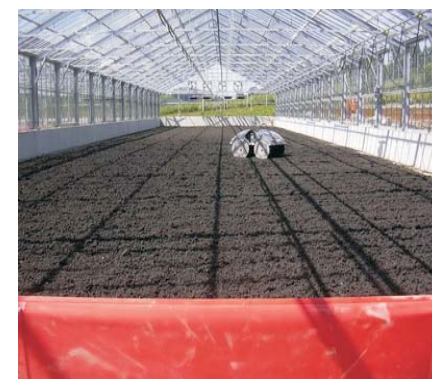
Schlamm Trocknungshalle innen
